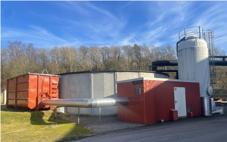
Figur 11. Luktreningsanläggning med biofilter.
